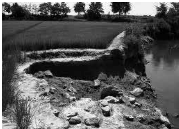
Fig. 18 cedimento di un argine. Tratto da http://ilpiccolo.gelocal.it
